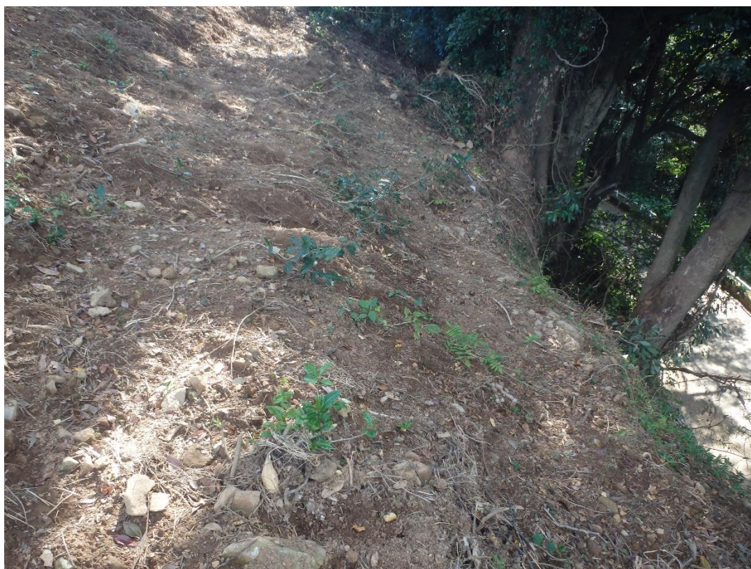
写真-6 ; 雨水の流下した痕がある。
