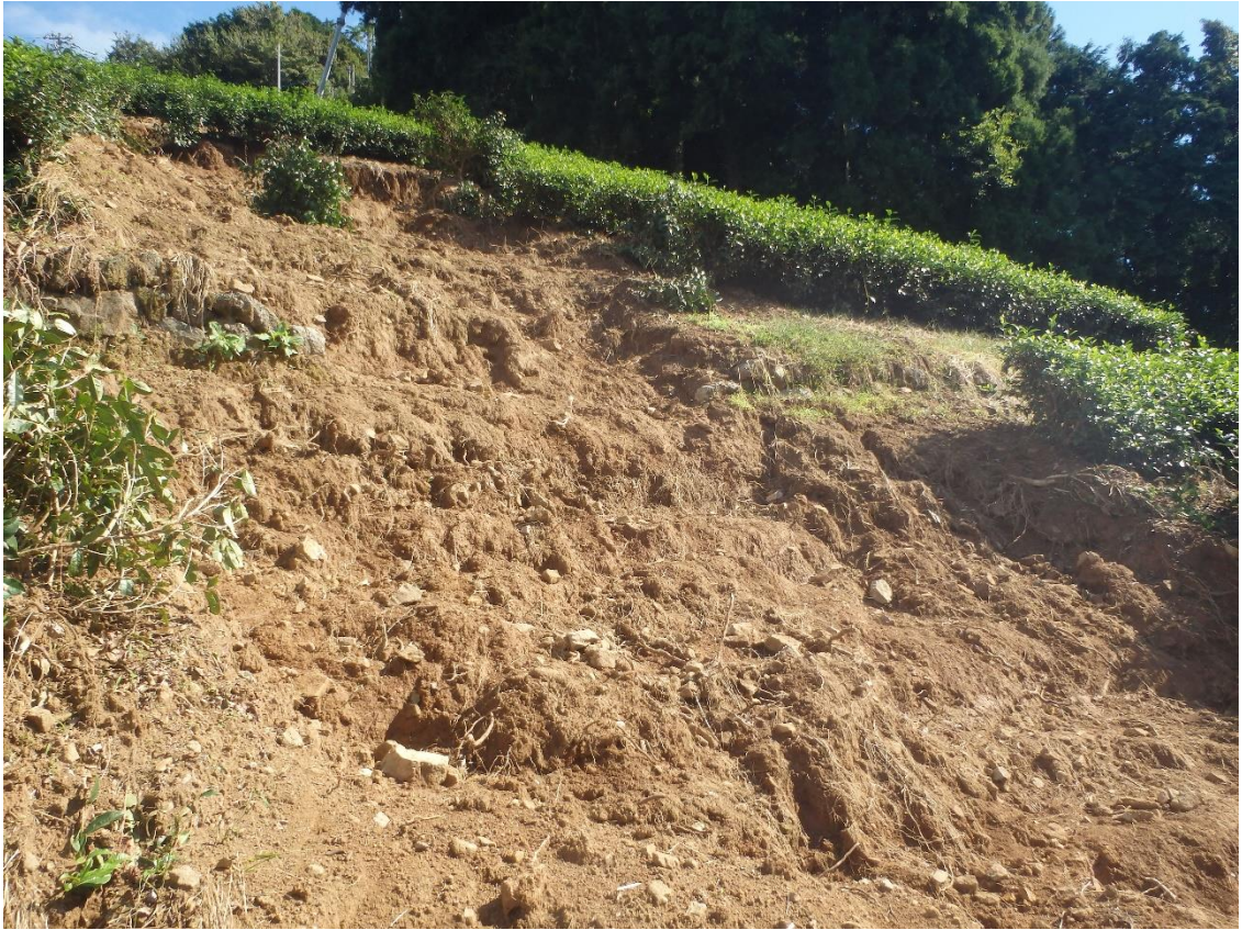
写真-1：崩壊頭部域（滑落崖比高約 50cm、幅約 5m、長さ約 25m、勾配約 30 度後退的に末端から崩壊が 3 回程あったと推定。）全体崩壊発は 30cm 程度。
