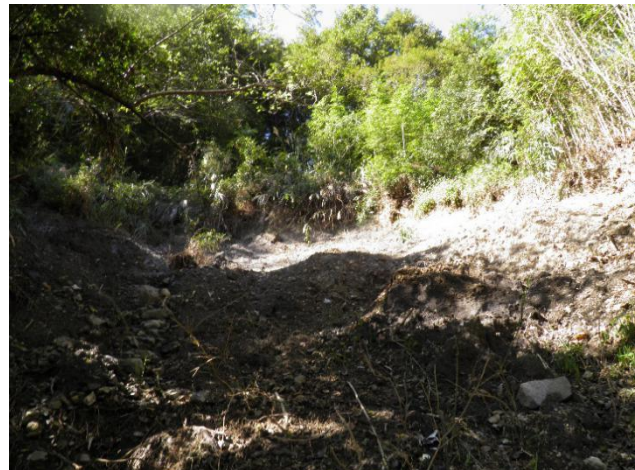
写真2 崩壊斜面の下部から滑落崖の状況
