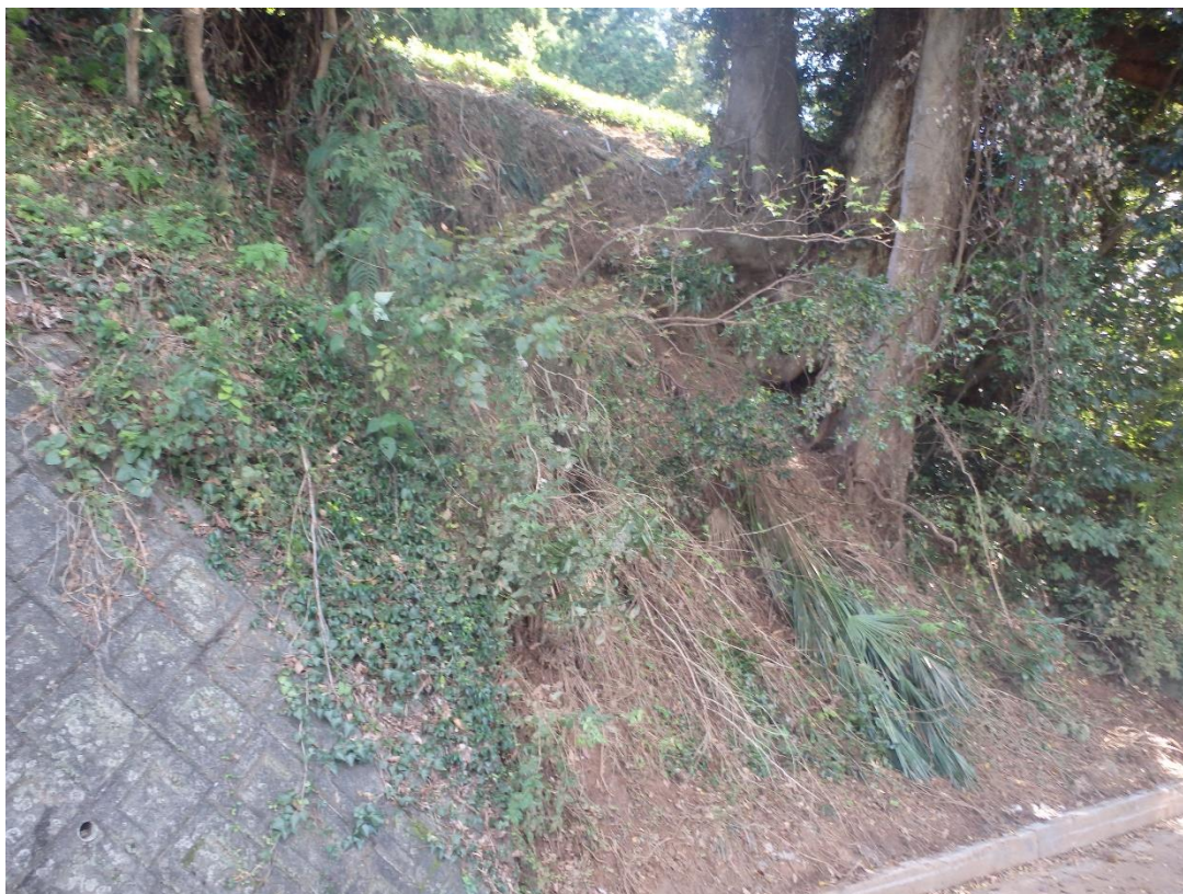
写真-5 : 左右ブロック積み施工してあるが、中央部だけ未施工。雨水の流下痕あり。
