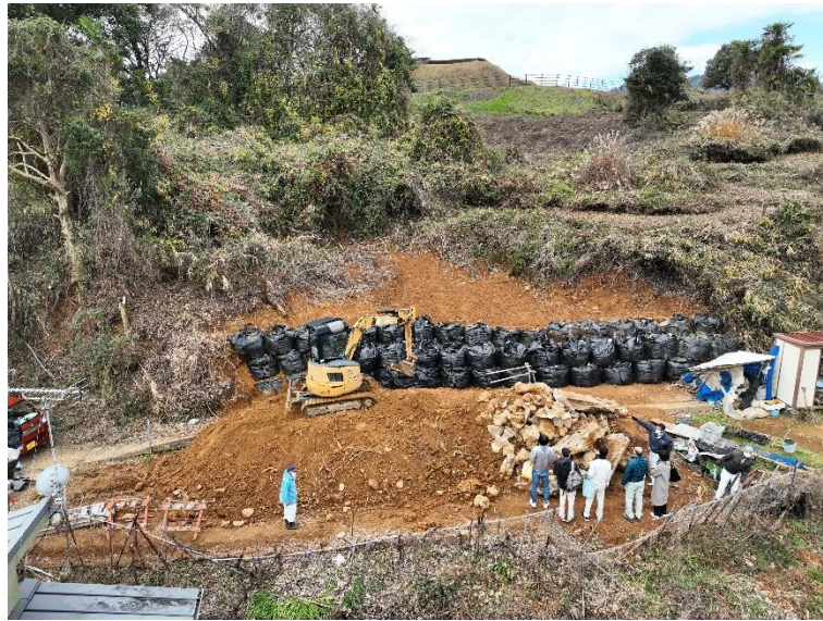
写真4 相談者宅裏の表層崩壊と大型土のうの養生土留め
