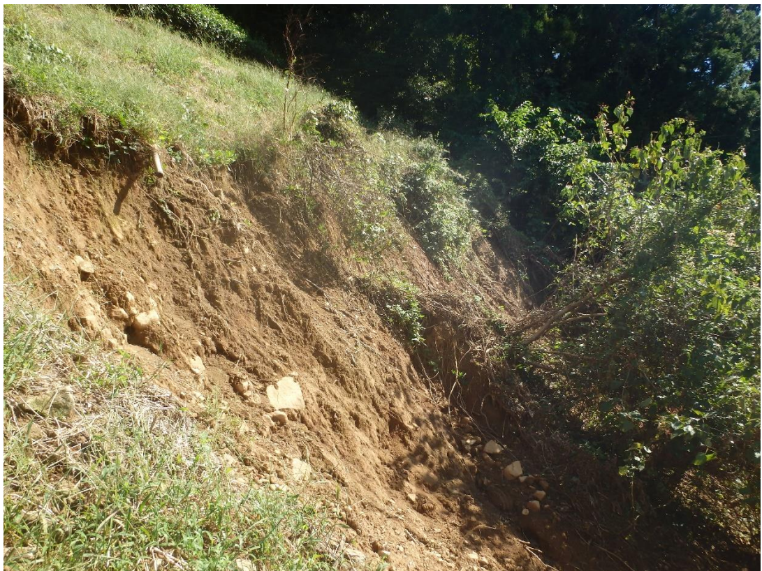
写真-8 : 別途崩壊地 (二次崩壊の危険はないが、崩土は緩いまま)
