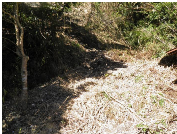
写真5 住宅裏の崩土
